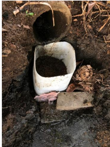
Figura 2. Wetland com a primeira camada de material filtrante inserida, já no local de instalação.
